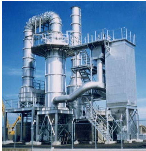
Slika 6.5.11 Postrojenje za insineraciju
