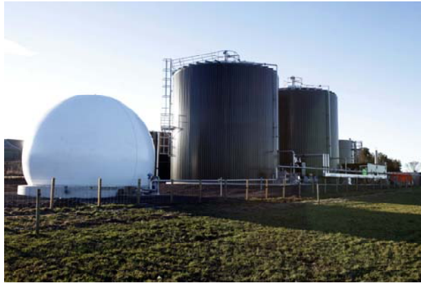
Slika 6.5.10 Postrojenje za anaerobnu digestiju
